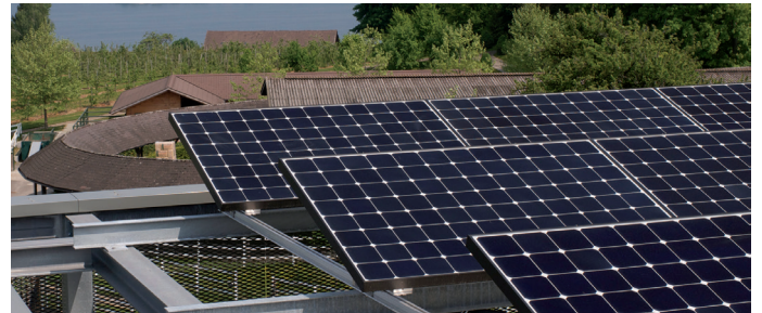
Die Solaranlage auf dem Gebäudedach hat eine elektrische Nennleistung von 38 kW.
